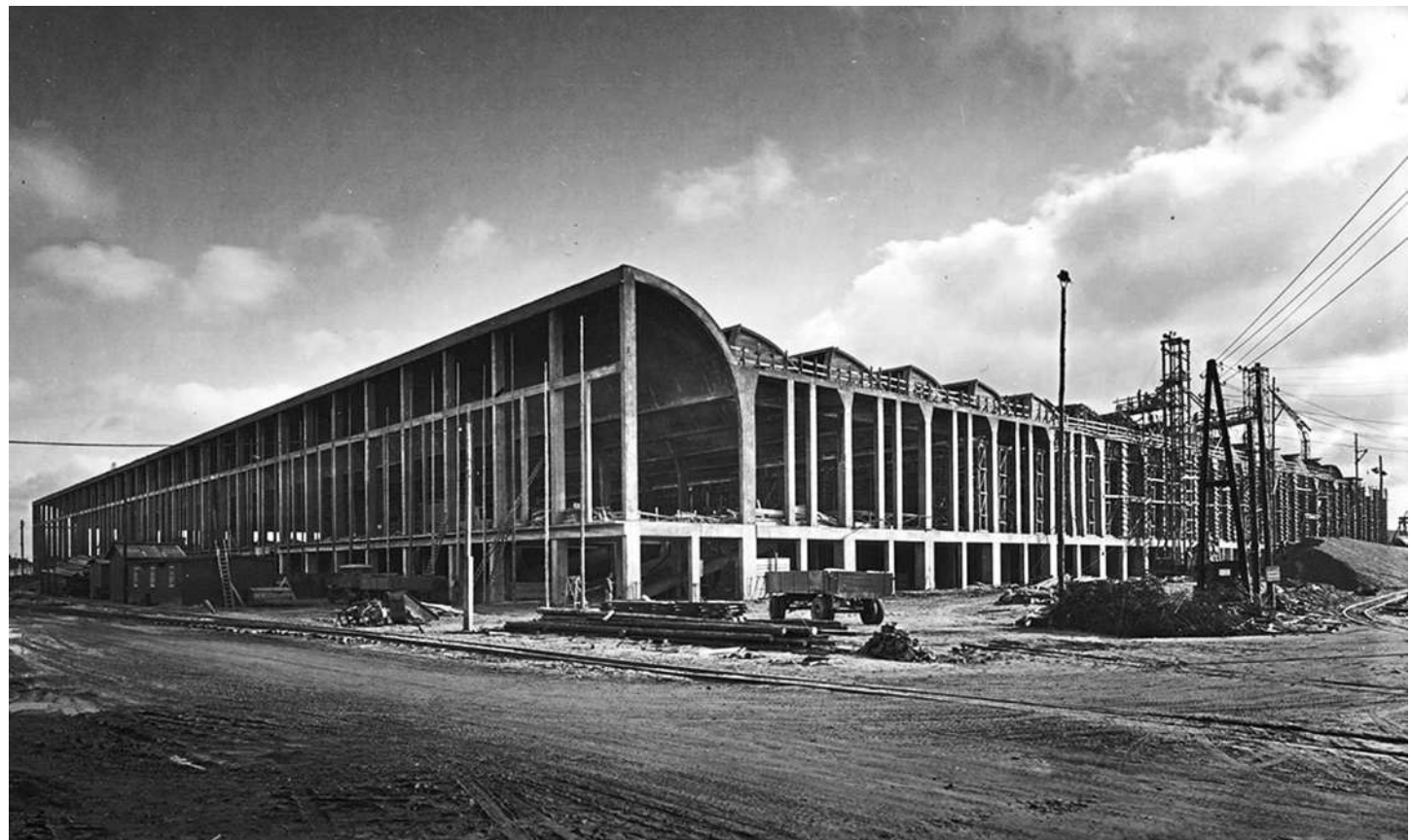
Hauptwerk der 1930er Jahre: Nach erfolgreichen Aufträgen von Daimler-Benz wurde Karl Kohlbecker gemeinsam mit drei anderen Architekten mit dem Bau des Volkswagenwerks in Wolfsburg betraut. Das Foto zeigt die Baustelle. Foto: Archiv Kohlbecker Gesamtplan GmbH
